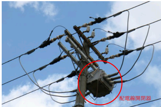
図 21. 配電線開閉器 [34]
