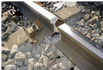
図1 レール破断の様子 [2]
