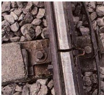
図1 破断したレールの様子 [3]
